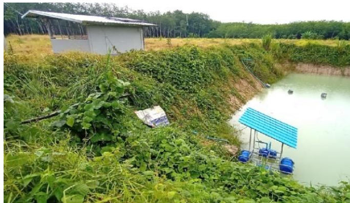
ภาพที่ 6 การใช้งานระบบสูบน้ำแบบแพลอยน้ำพลังงานแสงอาทิตย์
