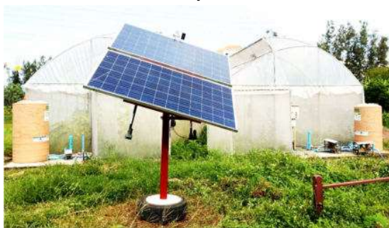
ภาพที่ 1 ระบบผลิตไฟฟ้าเซลล์แสงอาทิตย์แบบติดตามดวงอาทิตย์สองแกน ขนาด 600 วัตต์
