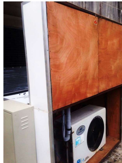
รูปที่ 13 ส่วนด้านหลังของชุดระบบปรับอากาศคอมเพรสเซอร์ กระแสตรงโดยใช้พลังงานแสงอาทิตย์
